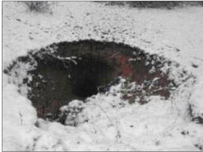
Fig. 19 : Effondrement d'une zone sous-cavée par suffosion [Source : BRGM]
